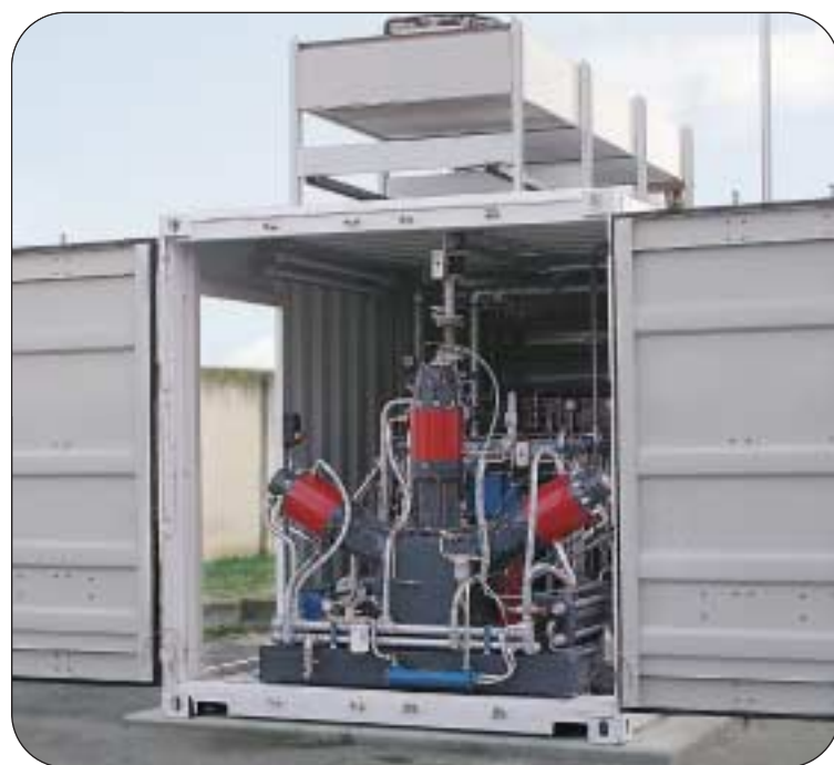
Kompressor-anlegg for CNG - naturgass. Høy-teknologi og sikkerhet preger anleggene til den italienske BRC.
